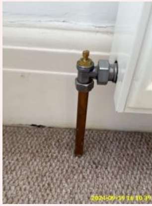
2:5 Heating Knob Missing - Tenant Maintenance
